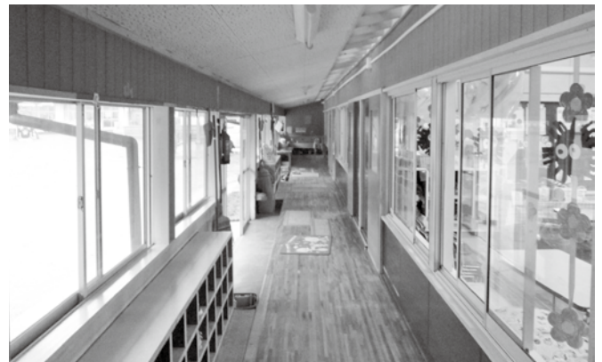
▲床の張り替えや部分的な修繕で対応している （※修繕計画に基づき、現在では全面修繕されています）
