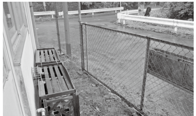
▲フェンスは老朽化が進んでおり、高さが低い
