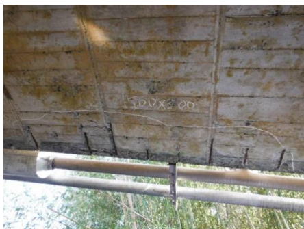
No.58 本郷橋【健全性Ⅲ】 （主桁）剥離・鉄筋露出
