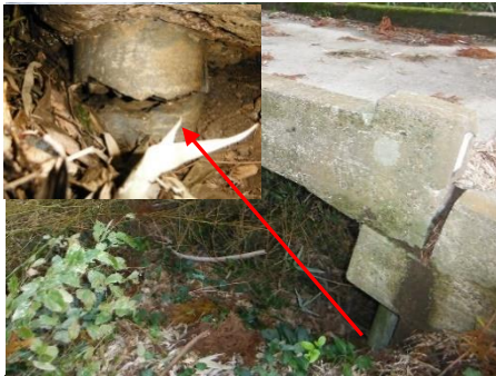
No.81 松ノ関橋【健全性Ⅳ】 （下部工）変形・欠損 ※2021年 架替済
