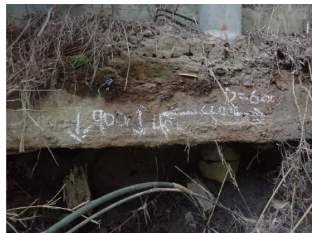
No.68 八坂橋【健全性Ⅲ】 （下部工）洗掘
